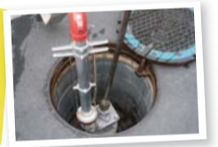
▲スタンドパイプ
